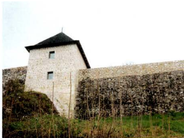
sl.2, originalni zid kastela (donji deo zida) sa veoma izraženom dekoloracijom i tamnom korom
