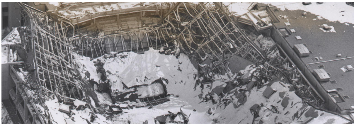
Слика 115. Приказ урушавања кровне конструкције од просторне решетке дворане “Hartford Civic Center” у САД-у. Несрећа се догодила 1978. године. Конструкција је димензија 100 m са 120 m. Мокри сњежни покривач дебљине 12 cm изазвао је попуштање једног штапа, а затим је уследила ланчана реакција и урушавање. Фотографија дјело Нејтана Симонса (Nathan Simmons).
