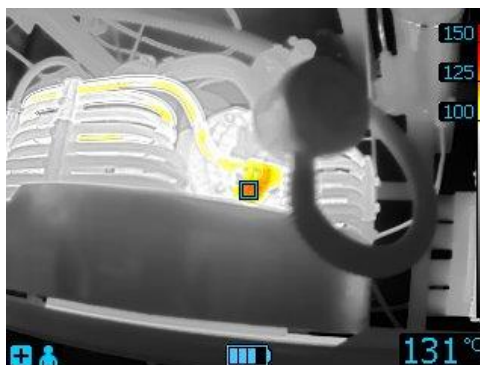
Slika 70. Termovizijska slika – temperatura na kompresoru prilikom punjenja.
