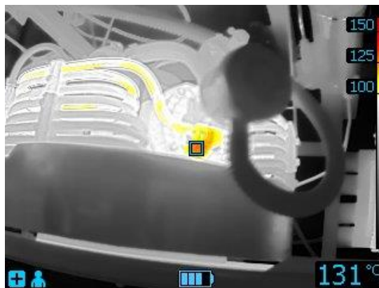
Slika 70. Termovizijska slika – temperatura na kompresoru prilikom punjenja.
