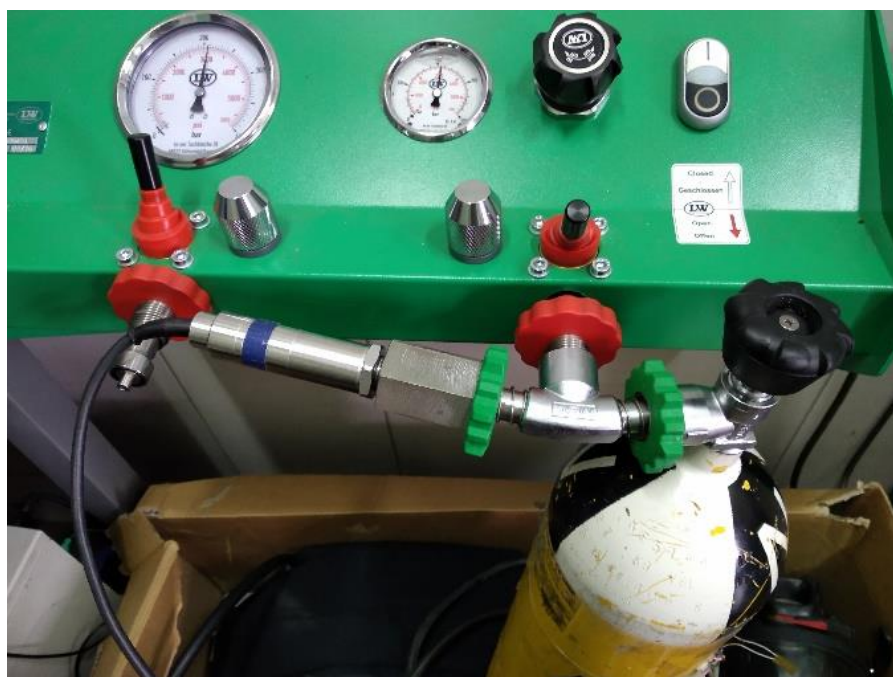
Slika 84. Čelična boca na konzoli „banke vazduha“.
